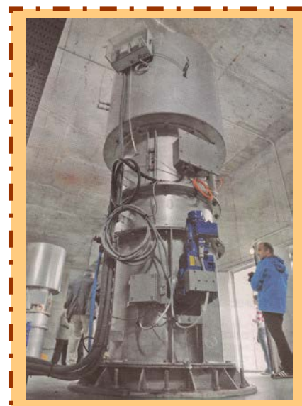
FOTO 50. Turbina del dique exterior de Mutriku.
